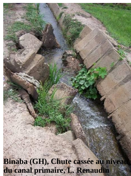
(D) : Chute cassée au niveau du canal primaire
