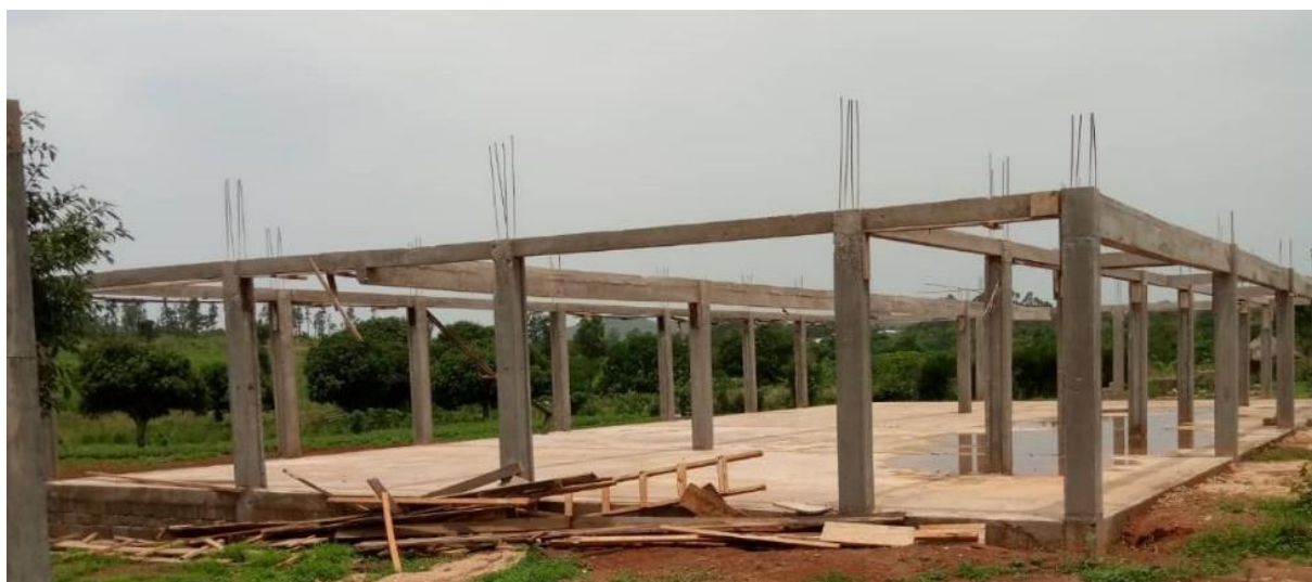
Photo 12: Magasin de stockage d'une capacité de 100 tonnes en construction à Rep-Yanga par ProCISA
